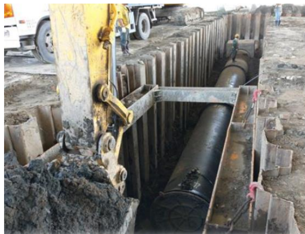
瓊林浮洲送水管
