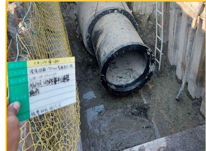
HDPE管預留平口以法蘭連接鋼管
