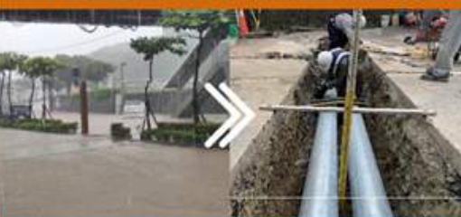
五股區成泰路一段98巷抽水井完成
